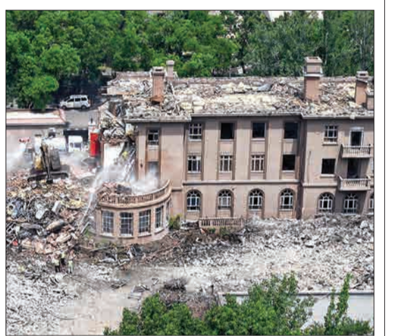
چین - کارگران در حال تخریب سفارت سابق آمریکا در پکن هستند که پیشتر در سال ۱۹۹۹ به آن حمله شده بود. این اتفاق یک روز پس از آن می‌افتد که نیروهای آمریکایی در بلغراد در میان کمپین بمباران ناتو، سه روز نامه‌نگار چینی را کشتند.
