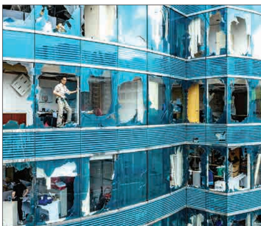
هنگ کنگ - پنجره‌های ساختمانی که پس از طوفان تخریب گرمانگهوت شکسته‌اند.
