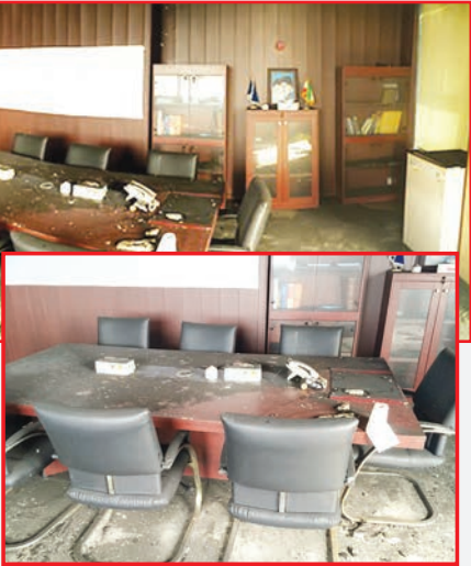
حادثه هولناک آتش‌سوزی در برج ۱۴ طبقه منطقه ویژه در عسلویه در کنار تلخی حادثه؛ صحنه‌های نادر و شگفت‌آوری هم داشت که نمونه آن سالم ماندن تنها یک اتاق از طبقاتی است که ۱۰۰ درصد منهدم شدند. به گزارش نفت‌نیوز: در پی آتش‌سوزی یکشنبه شب ۲۳ آذر ۹۳
